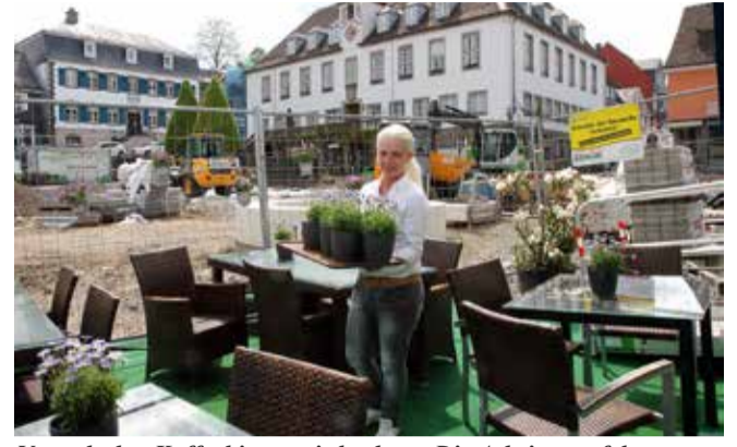
Vorne lecker Kaffee, hinten wird gebaut: Die Arbeiten auf dem Marktplatz sollen sich gar nicht oder nur wenig verzögern.
